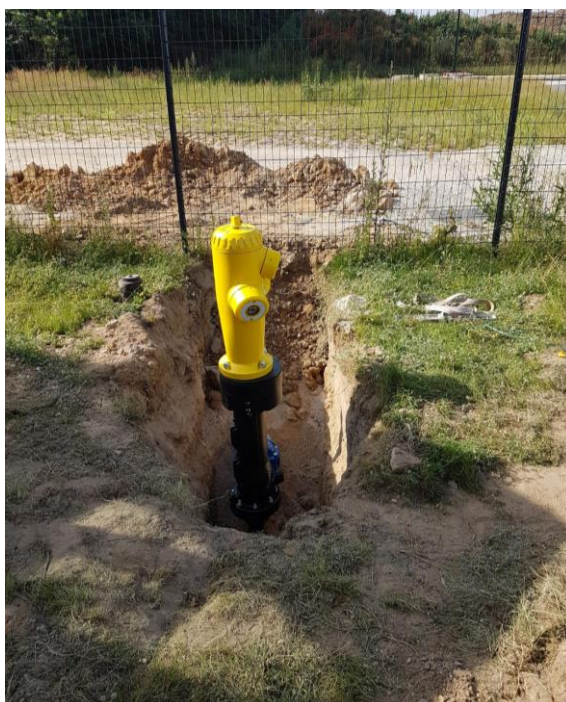
FIGURE 5 : POTEAU INCENDIE SURPRESSE
