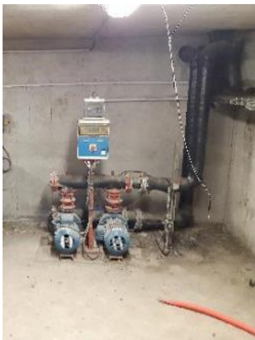
Figure 26 : Prise de vue photographique du poste de surpression RIA du site de Chaingy
