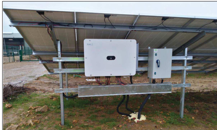
Figure 31 : Onduleurs photovoltaïques fixés à la structure porteuse des modules
