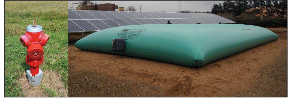
Figure 37 : Borne incendie (à gauche) et réserve incendie (à droite)
